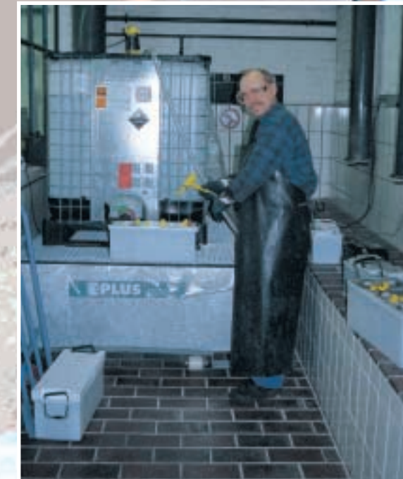
Beim Umgang mit Säuren im Batterieladerraum wird persönliche Schutzausrüstung benutzt. Die Entnahme der Säure erfolgt über eine Fasspumpe. Für den Batterietransport steht eine Karre zur Verfügung. ►
