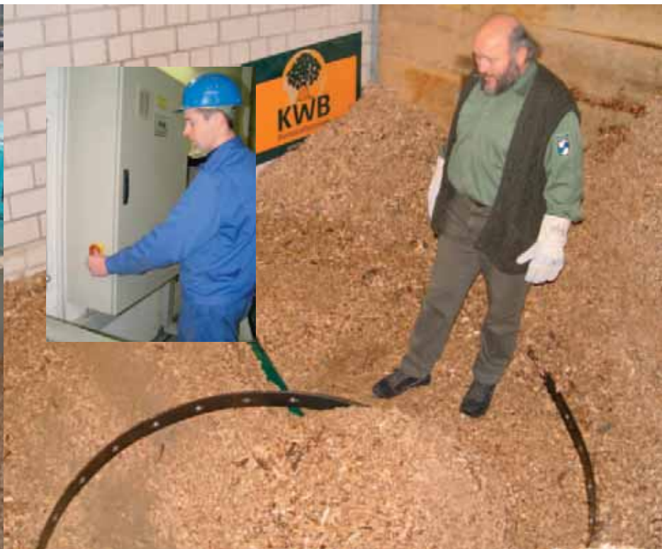
Im Hackschnitzel-Lagerbunker ist die Fördereinrichtung vor dem Betreten abzuschalten und gegen Wiedereinschalten zu sichern.
