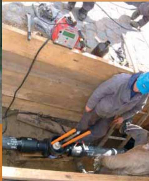
Auch PE-Schweißgeräte sind ortsveränderliche elektrische Betriebsmittel, die in leitfähigen Bereichen mit begrenzter Bewegungsfreiheit nur hinter einem Trenntransformator oder einem ungeerdeten Ersatzstromerzeuger betrieben werden dürfen.
