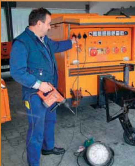
Zwei Verbraucher an einem ungeerdeten Ersatzstromerzeuger (Schutztrennung): Die Bohrmaschine ist direkt angeschlossen, während die Leuchte über einen zwischengeschalteten Schutzkleinspannungs-Transformator gespeist wird.
