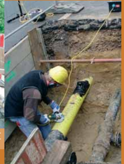
Rohrnetzbaustellen sind in der Regel leitfähige Bereiche mit begrenzter Bewegungsfreiheit. Jedes ortsveränderliche elektrische Betriebsmittel muss daher über einen eigenen ungeerdeten Ersatzstromerzeuger gespeist werden.
