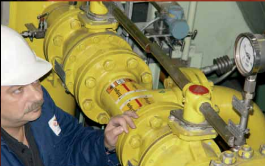
Das Betreiben von Anlagen erfordert auch regelmäßige Kontrolltätigkeiten vor Ort, wie z. B. das Ablesen von Temperaturen und Drücken.
