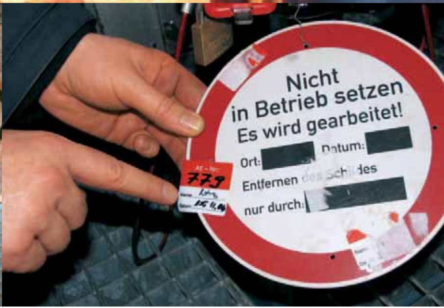
Unbefugtes Betätigen von Absperrvorrichtungen, Belüftungs- und Entleerungsarmaturen wird z. B. durch das Anbringen von Ketten und Schlössern sowie die Kennzeichnung mit Verbotsschildern verhindert.
