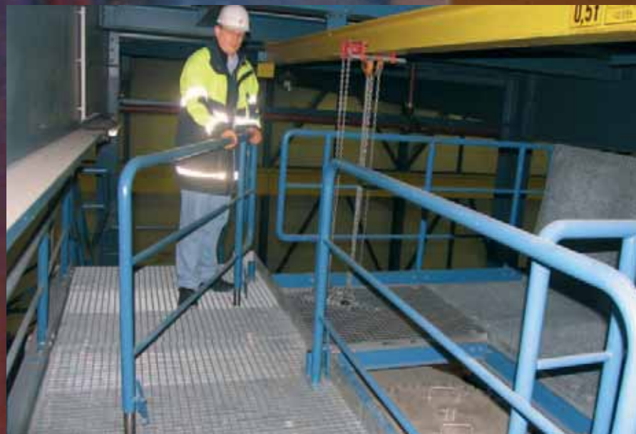
An Absturzstellen wird durch geeignete Absperrungen die Absturzgefahr deutlich reduziert.
