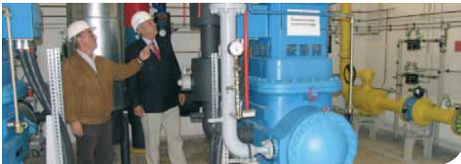
Das Herz der Anlage: Zwei in Reihe geschaltete Entspannungsturbinen zur Herabsetzung des Gasdrucks von etwa 40 auf 7 bar.
