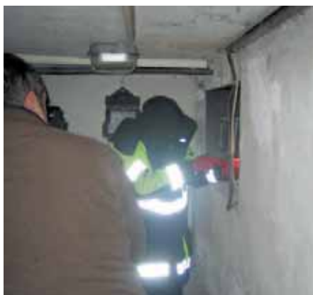
Bei Bedingungen wie z. B. räumlicher Enge oder schlechten Lichtverhältnissen sind „Arbeiten unter Spannung“ von einer zweiten Person zu überwachen (BGV A3 §8 DA).
