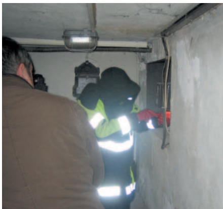
Bei Bedingungen wie z. B. räumlicher Enge oder schlechten Lichtverhältnissen sind „Arbeiten unter Spannung“ von einer zweiten Person zu überwachen (BGV A3 §8 DA).
